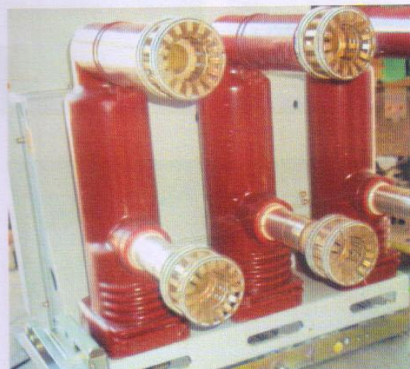
开关室引弧点(下触壁之间)
