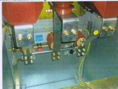
电缆室引弧点(三相母线之间)
